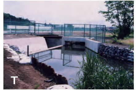
T 水量調整のための分流施設
